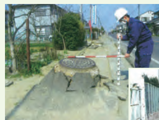
マンホールの浮き上がり (2011年東北地方太平洋沖地震)
