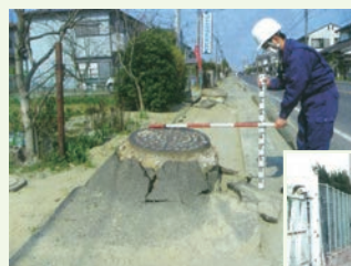
マンホールの浮き上がり (2011年東北地方太平洋沖地震)
