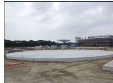
【メタン発酵槽】
