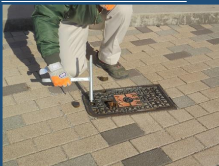
マンホールの蓋を開けます。
