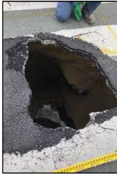
【下水道管きょに起因した道路陥没】
