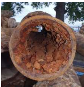
【錆による水道管の腐食】
