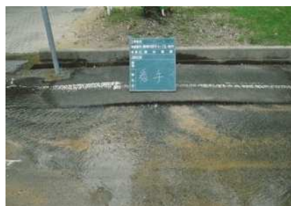
【水道管の破損による漏水】
