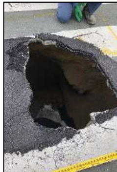
【下水道管きょに起因した道路陥没】
