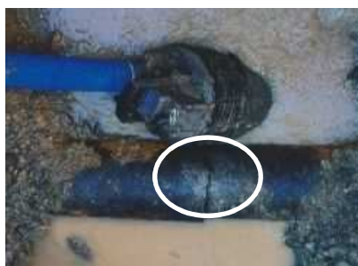
【地中で折れた水道管】
