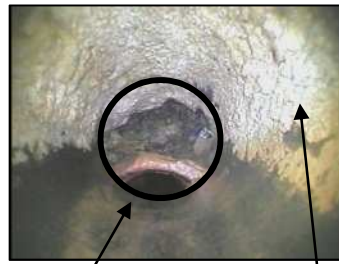
【劣化した下水道管きょ】
