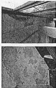
武道館 ●老朽化し、雨漏りが多発 ●空調設備・エレベーターがない ●同一フロアで同時利用3面まで ●隣接する競技面の距離を適切に確保できない
