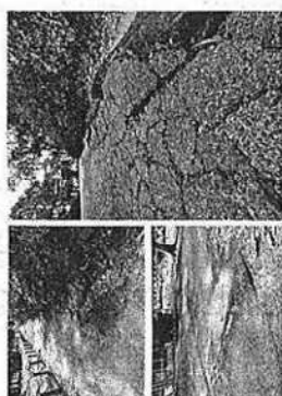
園内路 舗装の剥れや隆起した箇所が点在 車いす・ベビーカーでの移動が困難な上、 ジョギングやウォーキングでつまづく危険性も
