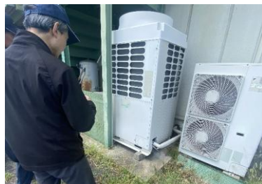
機器の設置状況等確認
