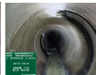
写真-4 ランクA 浸入水(破損)
