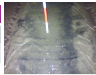
写真-3 ランクA 腐食
