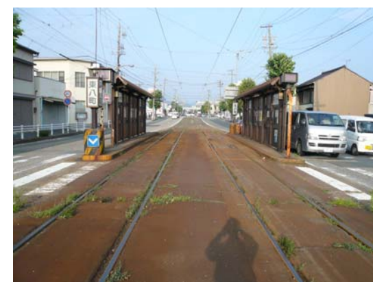
損傷が進む軌道敷（東八町電停付近）
