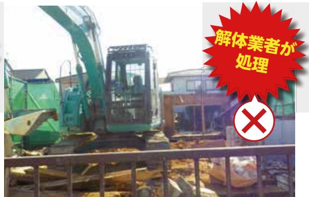
〈解体する建物等に残置された廃棄物〉
