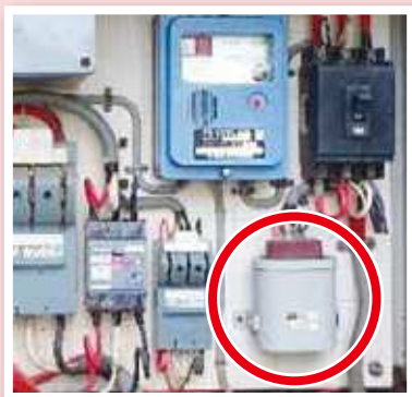
低圧分電盤内の低圧コンデンサー
