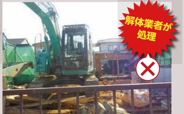
〈解体する建物等に残置された廃棄物〉
