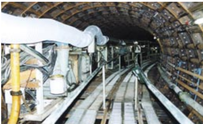
しもじうすいかんせん 下地雨水幹線工事 直けい 3 mの下水道トンネル工事
