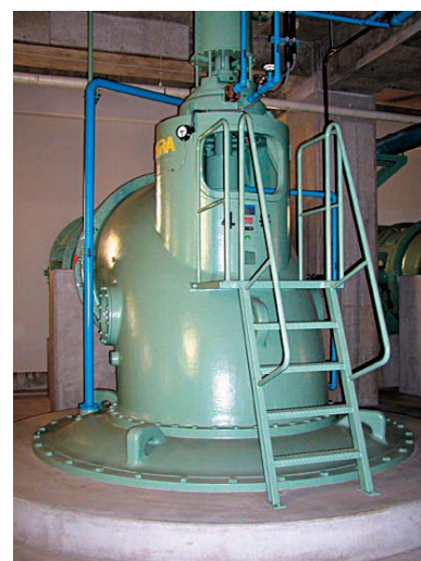
うすい 雨水ポンプ うすい 大雨のとき、雨水をす早くみあげて川 ほうりゅう に放流します。
