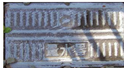
この中に水道メーターと水道を止めるバルブがあります。
