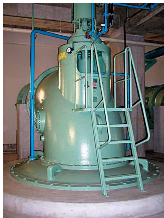
雨水ポンプ 大雨のとき、雨水をす早く汲み上げて川 に放流します。
