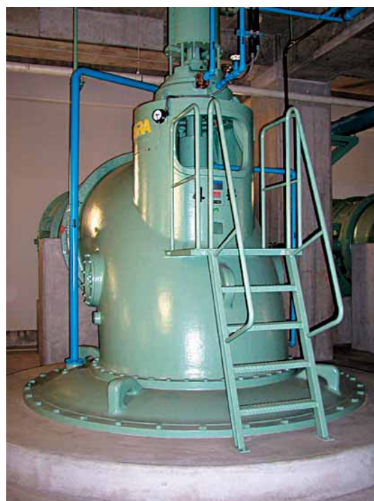
雨水ポンプ 大雨のとき、雨水をす早く汲み上げて川に放流します。
