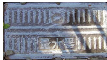
この中に水道メーターと水道を止めるバルブがあります。
