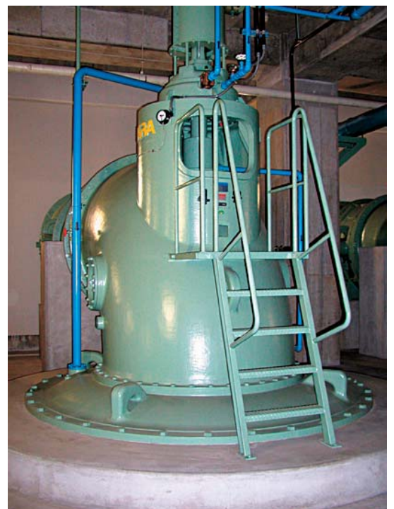
うすい 雨水ポンプ 大雨のとき、雨水をす早く汲み上げて 川に放流します。
