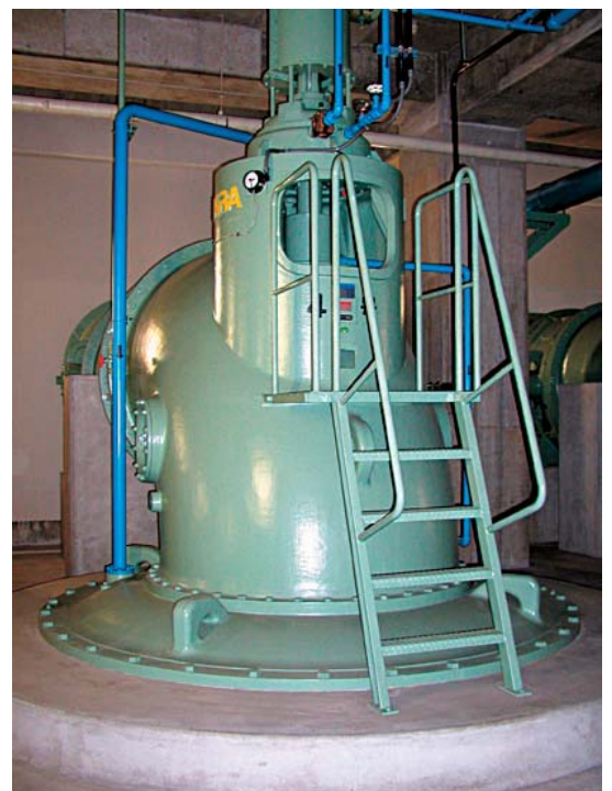
うすい 雨水ポンプ 大雨のとき、雨水をす早く汲み上げて 川に放流します。
