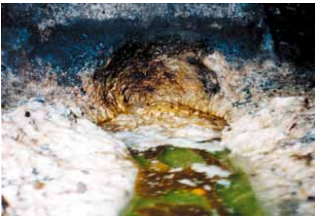
油でべとべになった管 （下水道管：直径20cm）
