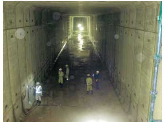
前田南雨水調整池 幅7m 高さ7.2m 長さ112.5m 雨水貯留容量3,600m 3 2014年(平成26年)7月
