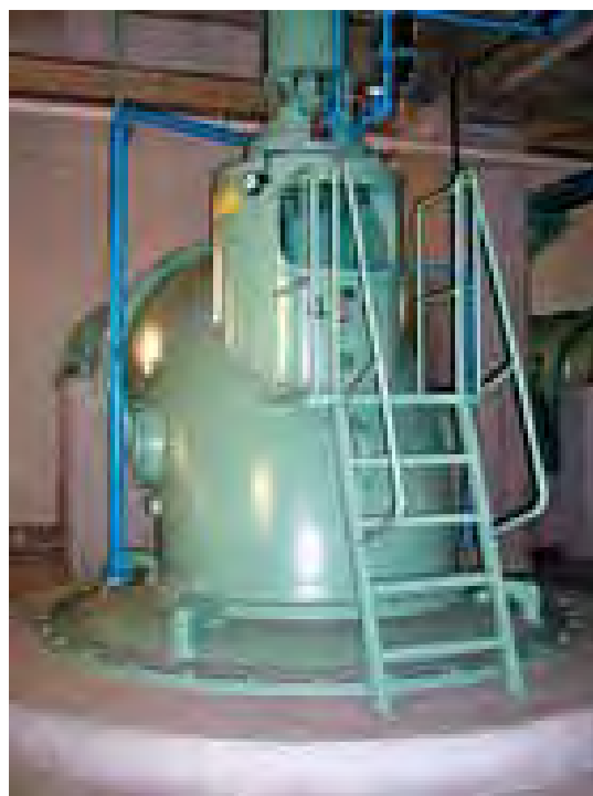
うすい 雨水ポンプ あまみず 大雨のとき、 く 雨水をす早く あ 汲み上げて ほうりゅう 川に放流します。
