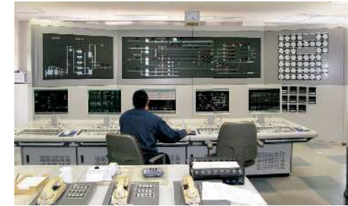
配水圧力の管理室の様子
