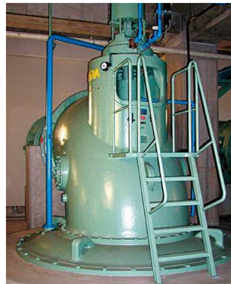
雨水ポンプ 大雨のとき、 すばやく 雨水を素早く汲み上げて川に放流 ほうりゅう します。
