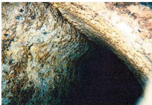
酸でぼろぼろになったコンクリート管 (下水道管：直径2m)
