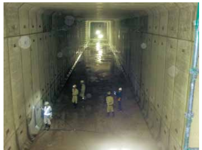
前田南雨水調整池 幅7m 高さ7.2m 長さ112.5m 雨水貯留容量3,600m 3 2014年(平成26年)7月
