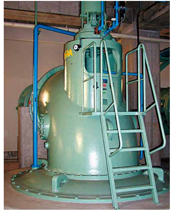
雨水ポンプ 大雨のとき、雨水を素早く汲み上げて 川に放流します。
