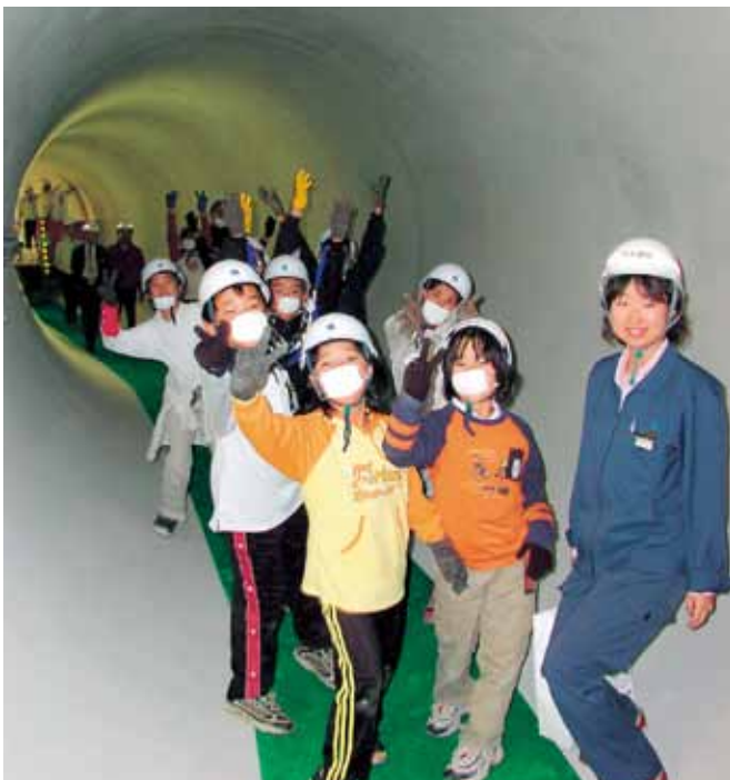
下地雨水幹線 直径3.0m 2001年(平成13年)12月
