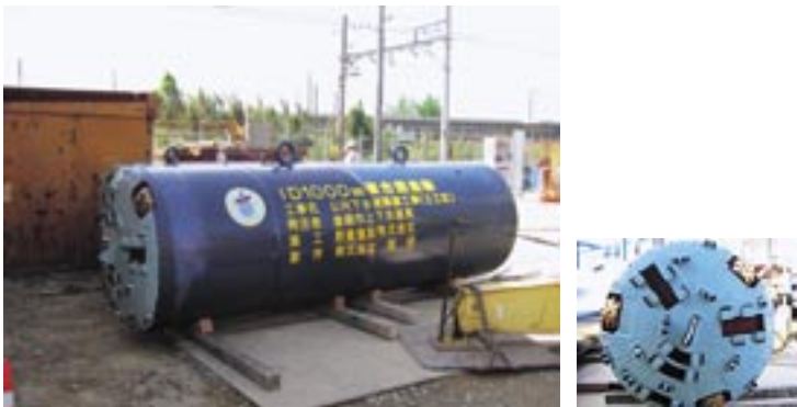
うめだだいいちおすいかんせん 梅田第1汚水幹線(大岩・二川地区) さいちようきろく たっせい きかい 世界最長記録を達成した機械 すいしんこうほう えんちよう きろく 推進工法というトンネル工事で延長1448mを記録
