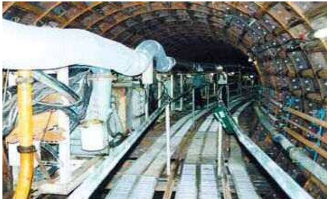
しもじうすいかんせん 2001年(平成13年) 下地雨水幹線工事 ちよっけい 直径3mの下水道トンネル工事
