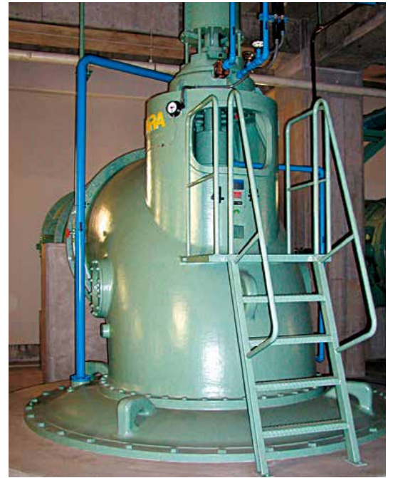
雨水ポンプ 大雨のとき、雨水を素早く汲み上げて川 に放流します。
