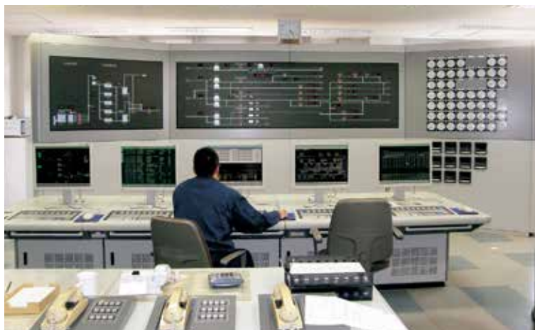
はいすい あつりよく かんり しつ 配水圧力の管理室の様子
