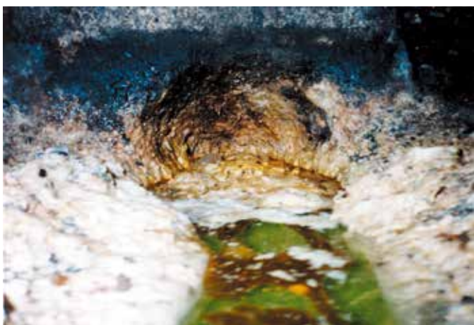
油でべとべとになった管 (下水道管：直径20cm)
