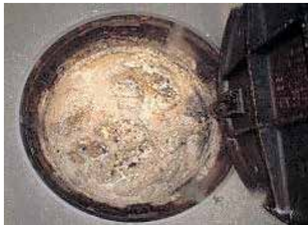
油でマンホールがつまった状態
