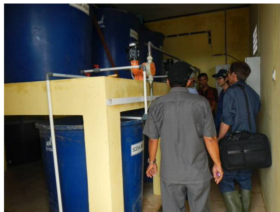
薬品注入設備
