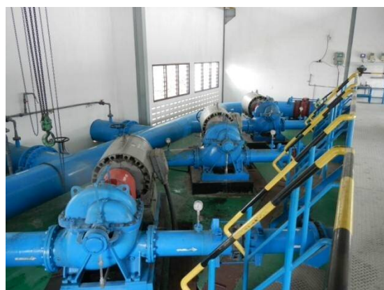
配水ポンプ設備
