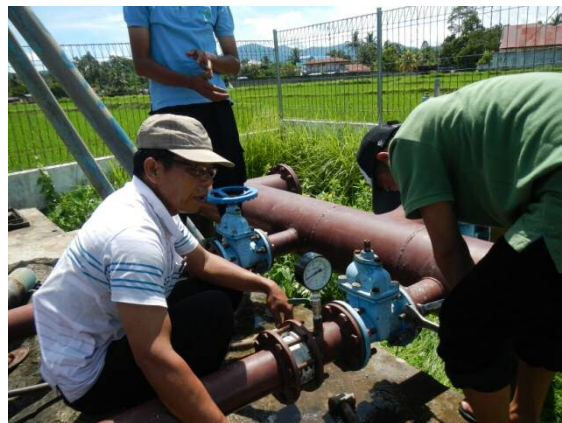
設備保守点検実習
