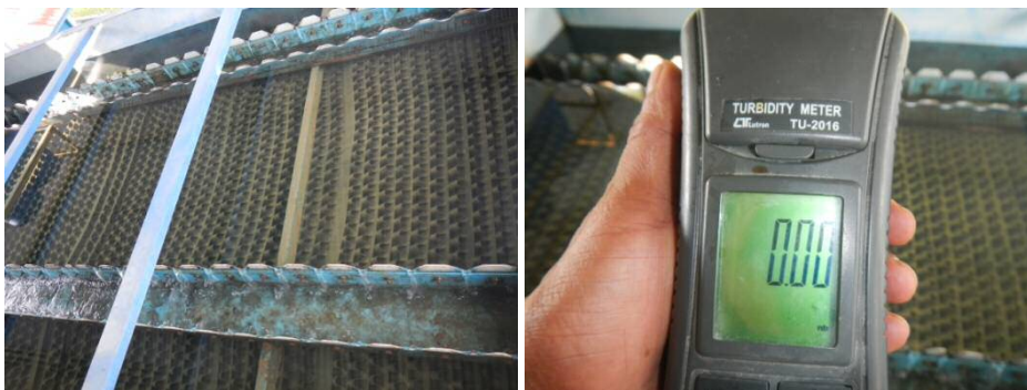
沈澱池の改善状況 (出口濁度0.00度を確保)
