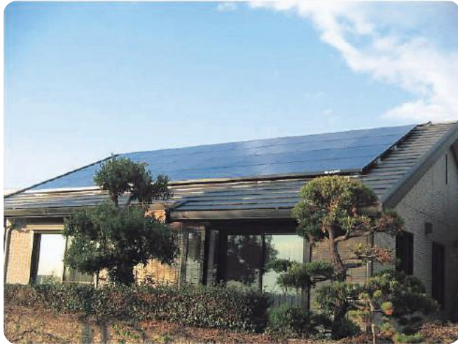
住宅用太陽光発電システム
