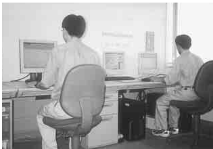
大気汚染常時監視テレメータシステム（中央監視局）
