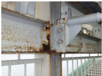
写真 塗装劣化
