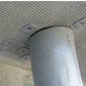
写真 剥落対策
