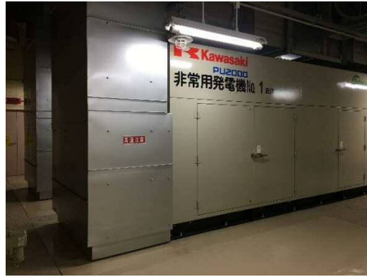
非常用発電機
