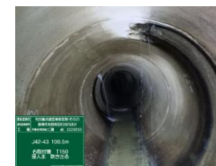
写真-4 ランクA 浸入水(破損)
