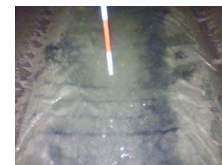
写真-3 ランクA 腐食
