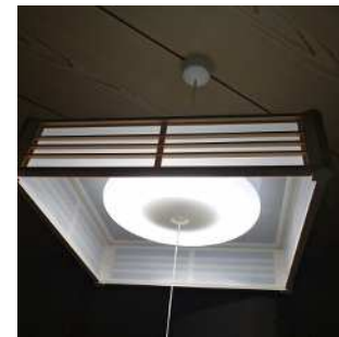
照明器具LED化 バッグ
