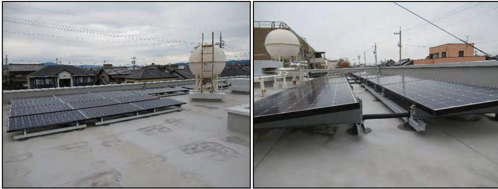
図 2-1 太陽電池パネルの設置例（豊橋市牟呂校区市民館）
