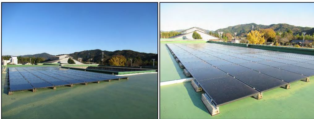
図 2-2 太陽電池パネルの設置例（新城市立新城小学校）
