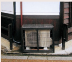
● 空調室外機の覆い
