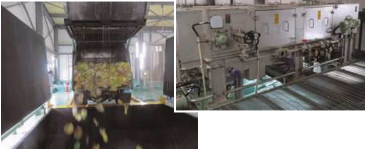
生ごみピット
