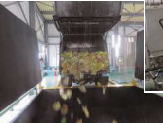
生ごみピット
